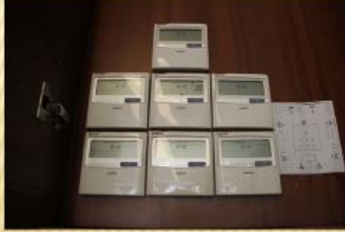
Genel Yerlerin termostati
